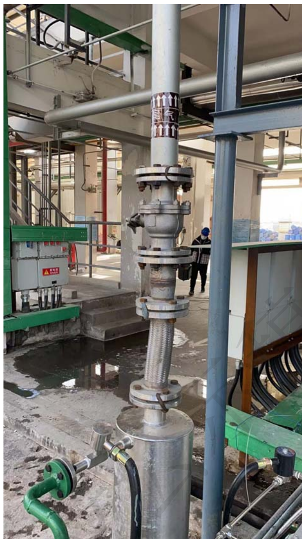
图 3.6-1 生产车间真空泵尾气收集设施
