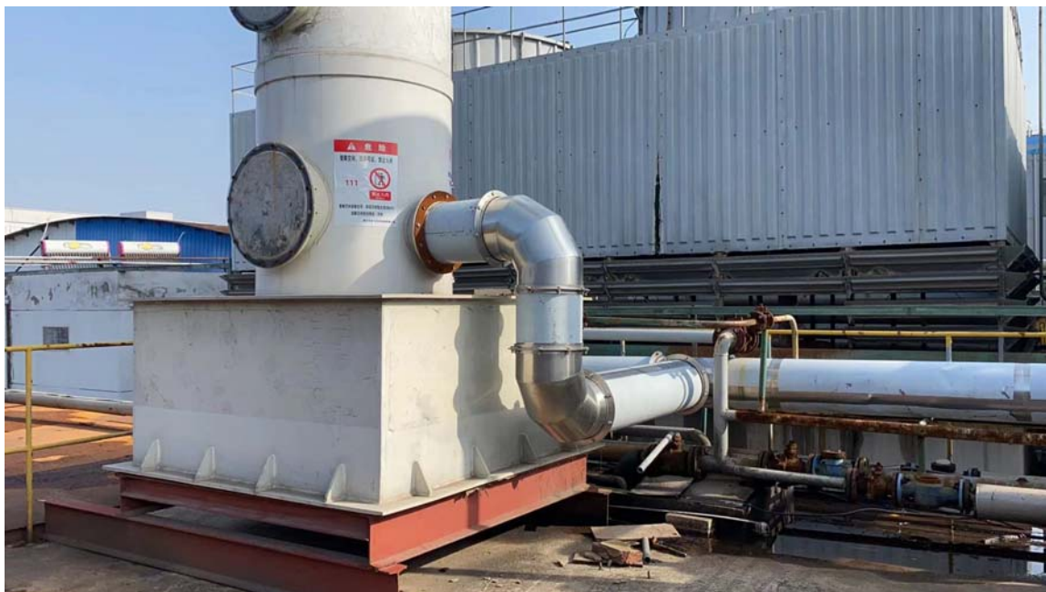
图 3.6-6 厂区现状污水处理设施
