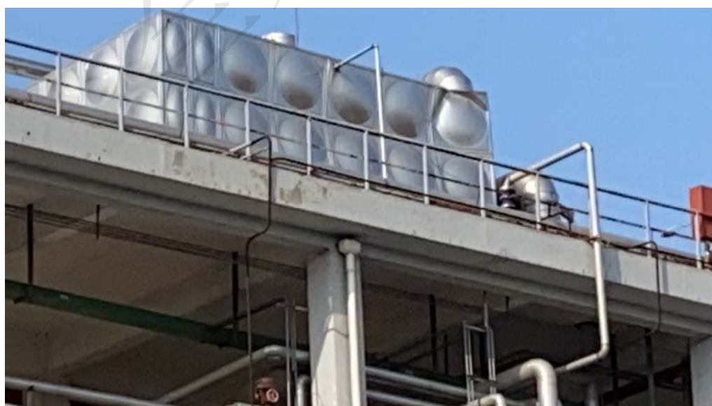
图 3.6-2 壬基酚现状屋顶生物除臭+一级活性炭装置及排口
