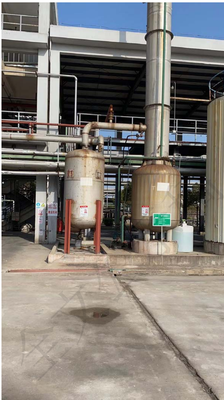
图 3.6-3 表活废气处理装置及排放口
